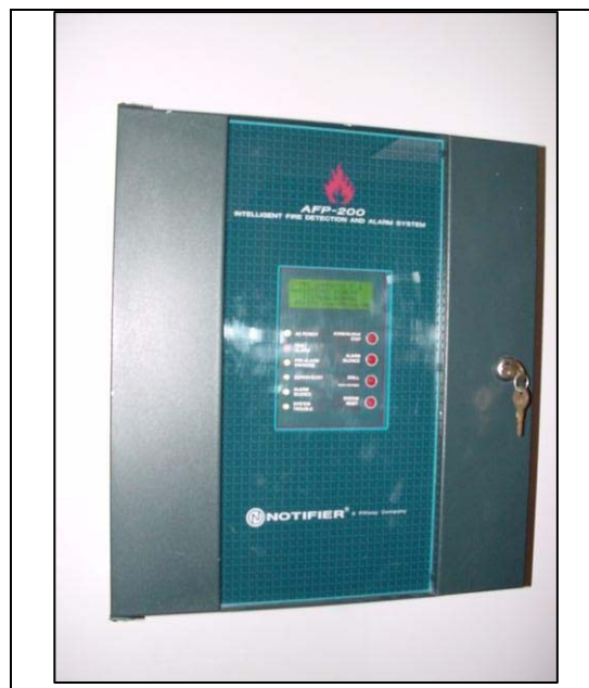
Central de incendio asociada al sistema principal (COR)
