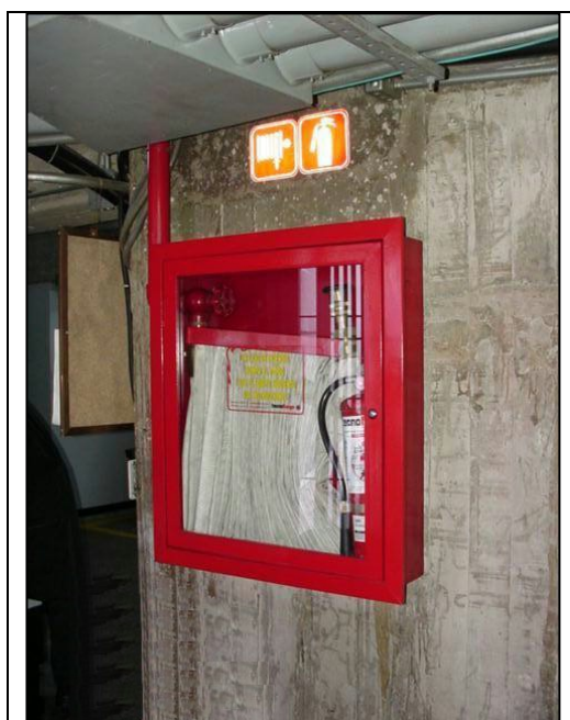
Gabinete con Manguera de Extinción de Incendios Sotano COR
